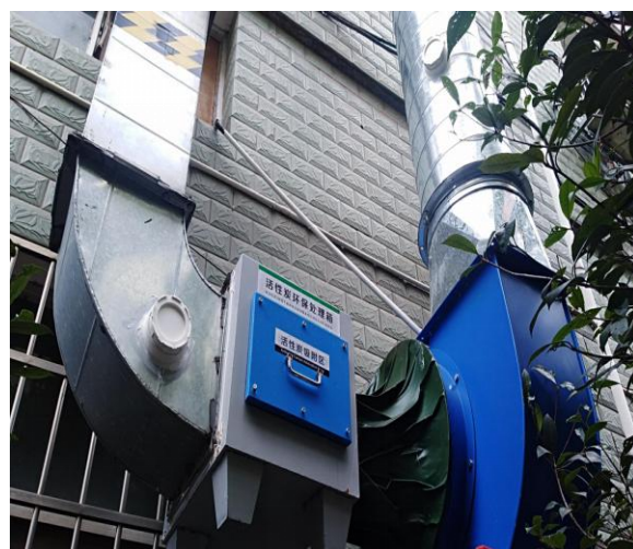
注塑废气处理装置
