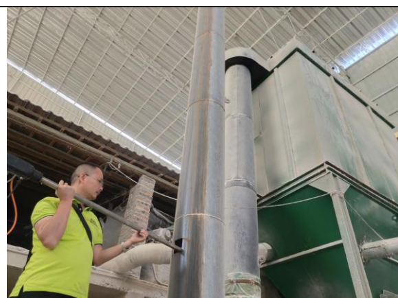
布袋除尘废气出口
