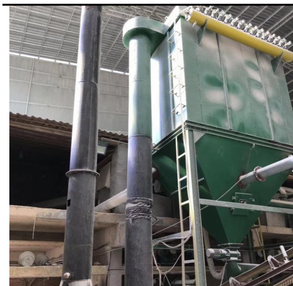
布袋除尘处理设施
