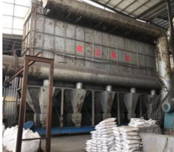
烟化炉废气处理设施
