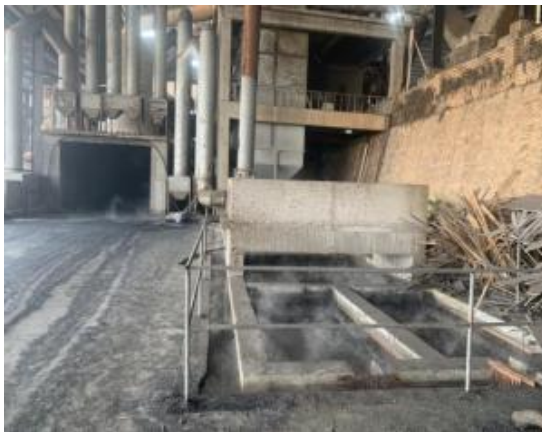
烟化炉冲渣废水沉淀池
