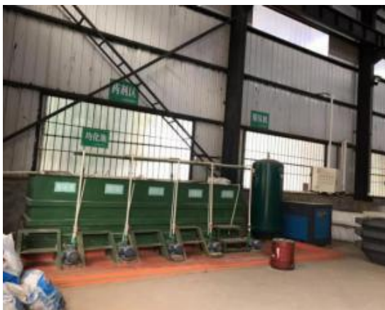
污水处理设施
