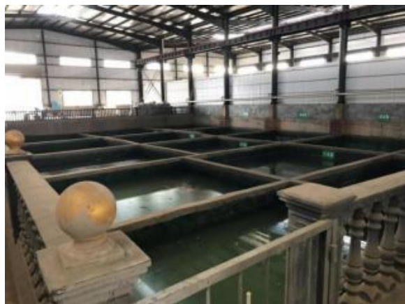
污水处理设施
