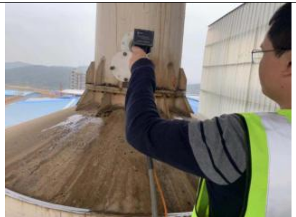
2#酸雾净化塔出口采样照片
