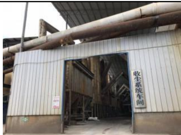
反射炉废气处理设施
