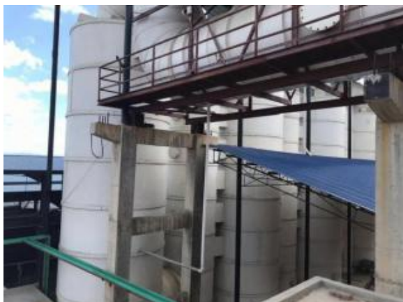
脱硫塔废气处理设施
