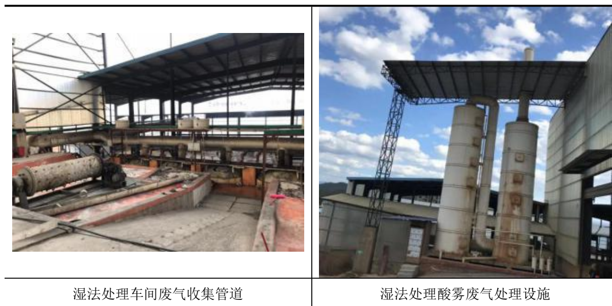
图 4-2 废气处理设施照片
