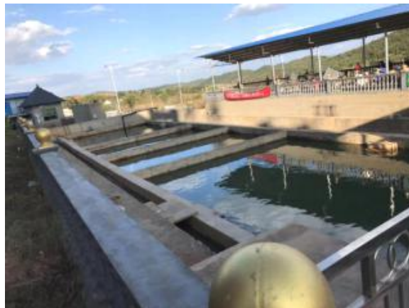
初期雨水沉淀池
