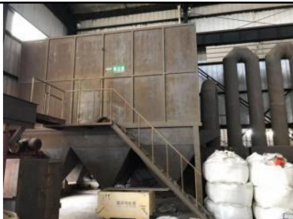
原料制备废气处理设施
