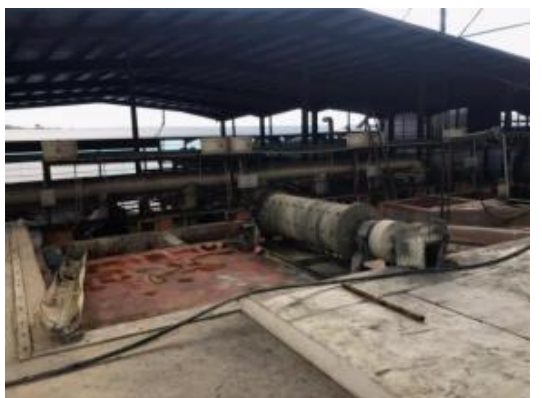
脱硫塔废水沉淀池
