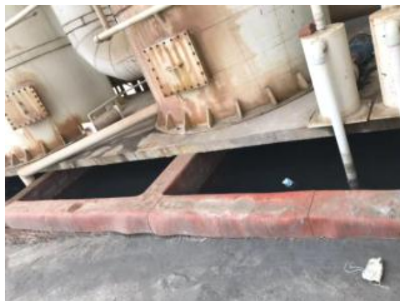
酸雾喷淋塔废水沉淀池
