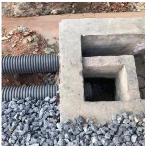
生活污水排口
