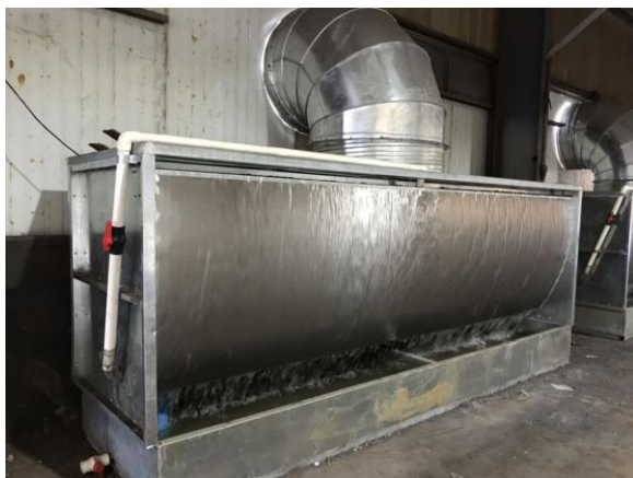
喷漆房废气处理循环水池
