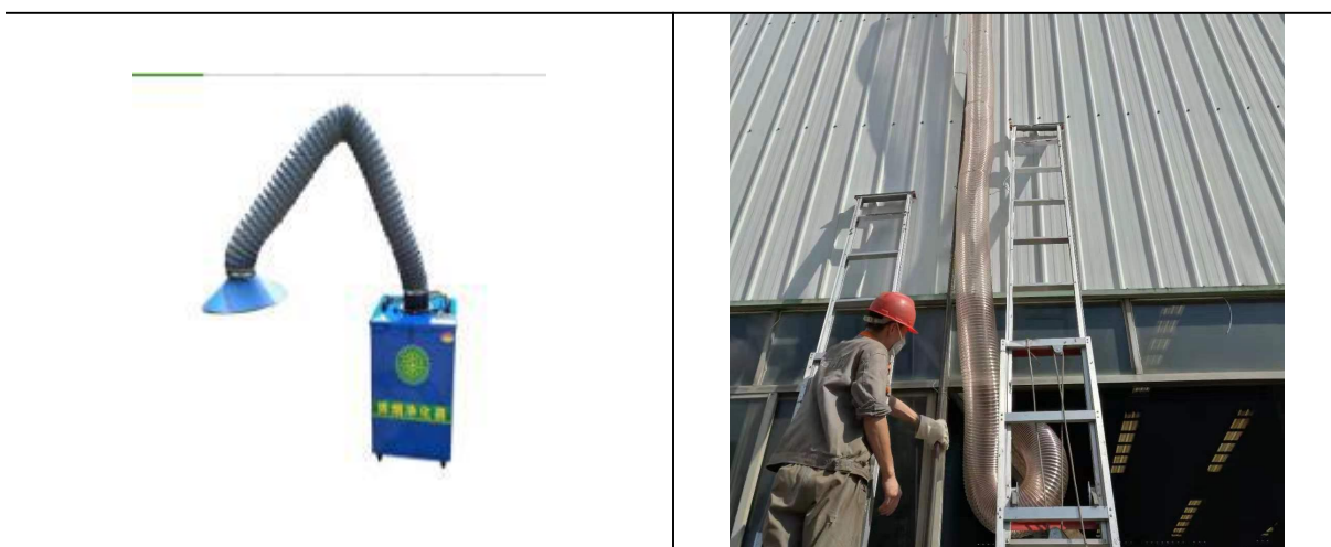
焊接处理设施
