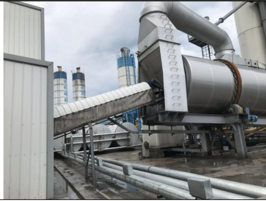
封闭式运输皮带
